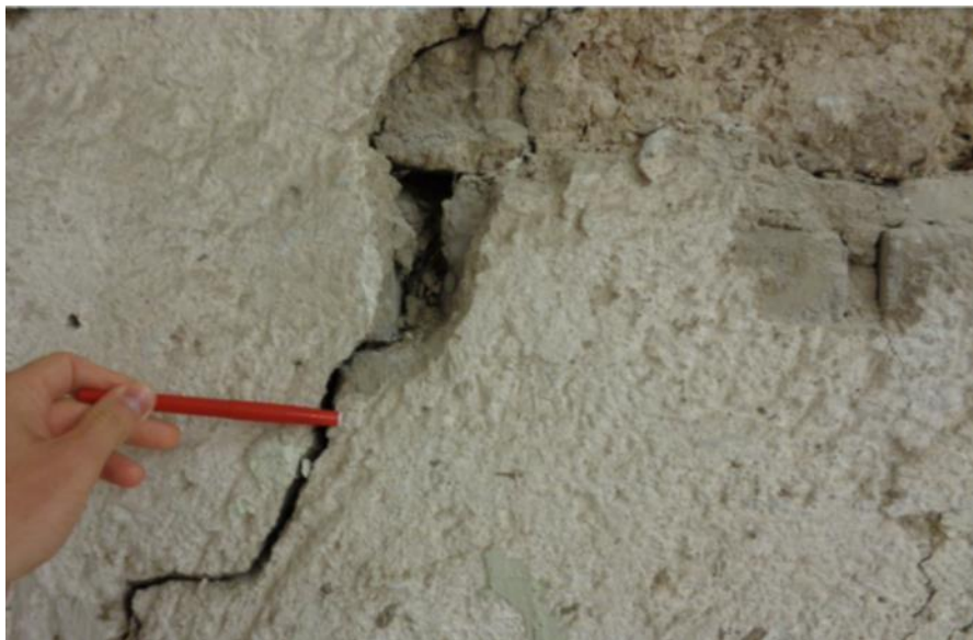
Abbildung 3: Rissverhalten der betroffenen Wand vor der Entfernung des Verputzes
