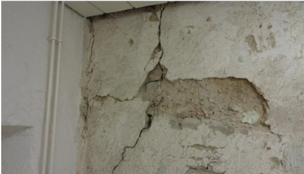
Abbildung 10: Risse der Wand im EG (Seite Nord)
